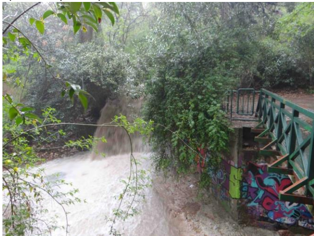
Στο γεφυράκι του Αγ. Αθανασίου μετά από βροχή
